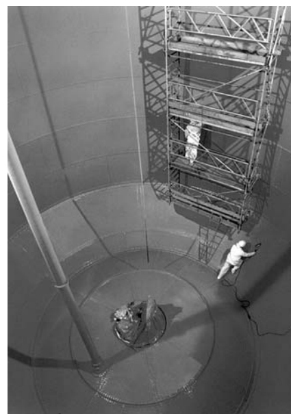
Porenprüfung der Beschichtung in einem historischen, genieteten Stahlbehälter
