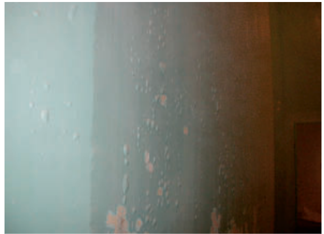
Abb. 3: Blasen unter einer lösemittelhaltigen, 30 Jahre alten Epoxydharzbeschichtung auf lösemittelhaltigem Spachtel
